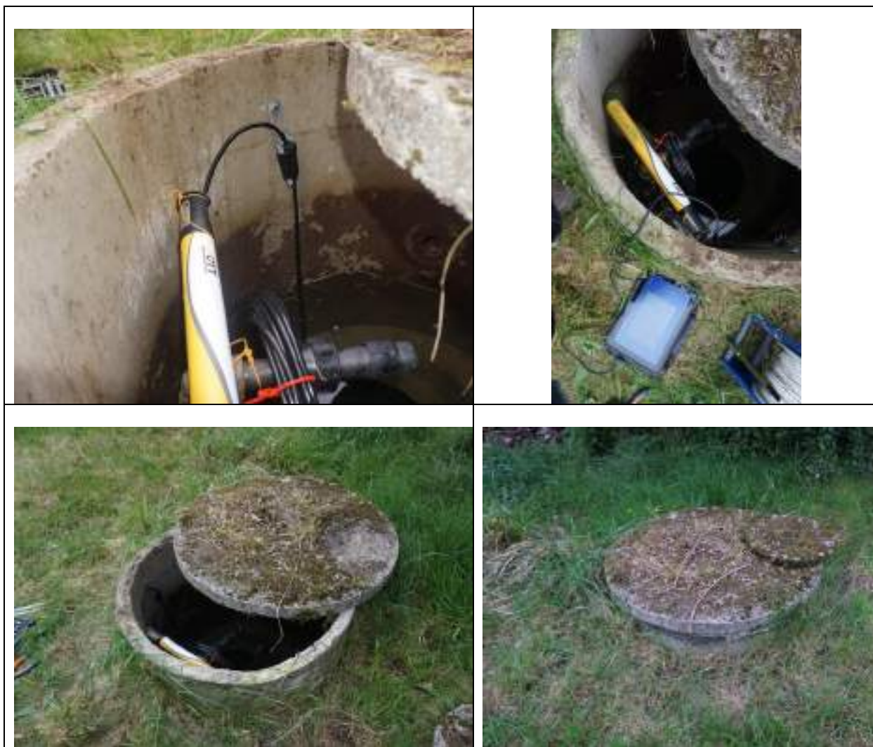
Illustration 21 – Installation de la sonde sur le point BSS002DDXS (Callory, Commune de Labastide-Saint-Pierre)
