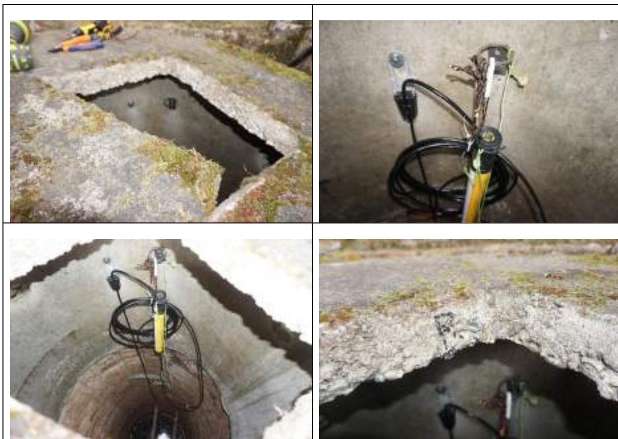
Illustration 24 – Installation de la sonde sur le point BSS002EGZN (Bezette, Commune de Savenès)
