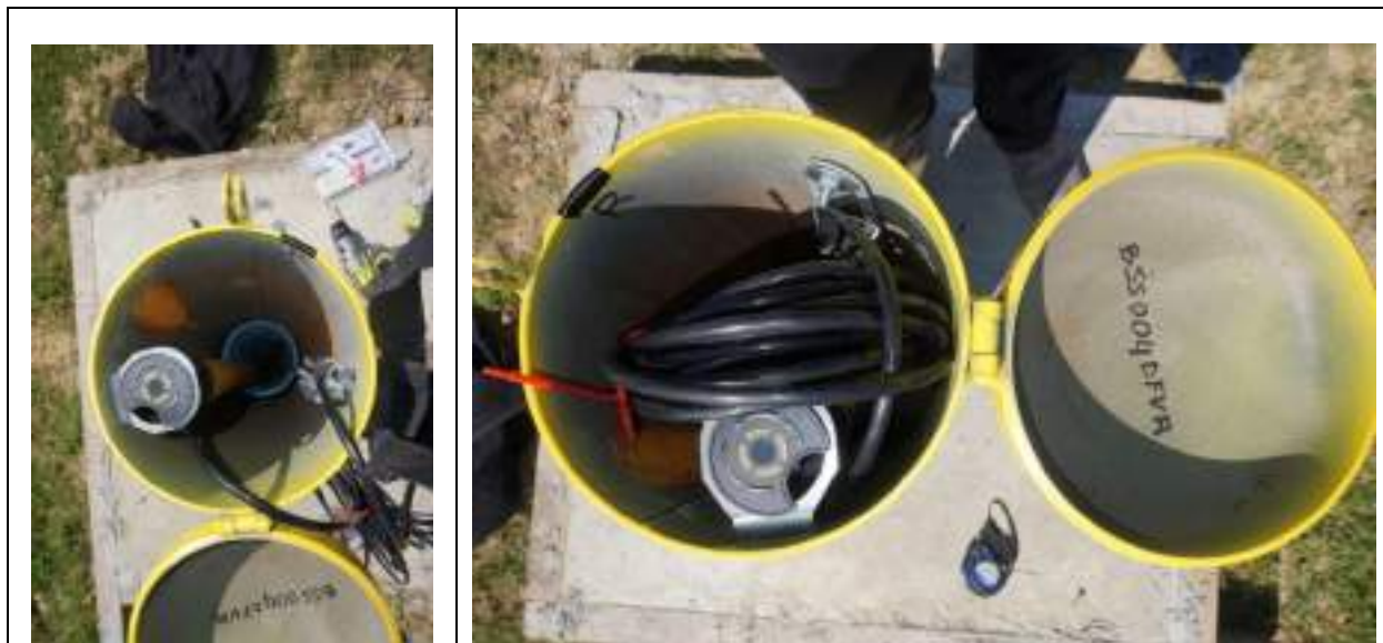
Illustration 18 – Installation de la sonde sur le point BSS004DFVR (Valence Quercy, Commune de Valence d’Agen)
